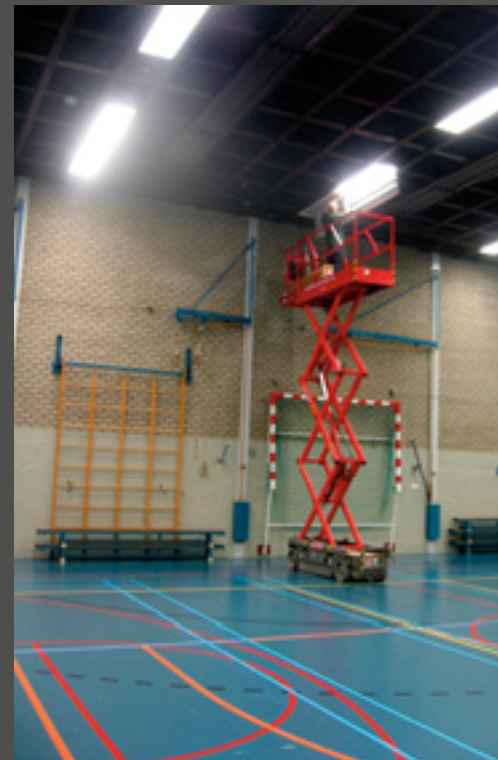
Bij het vernieuwen van de verlichting is gebruik gemaakt van de huidige armaturen.
